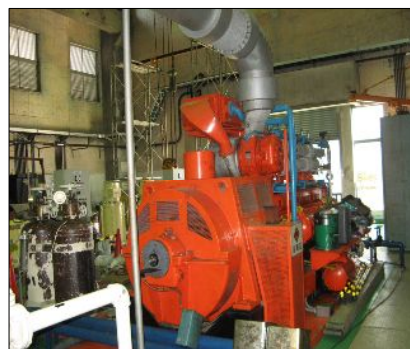
東部ポンプ場内
